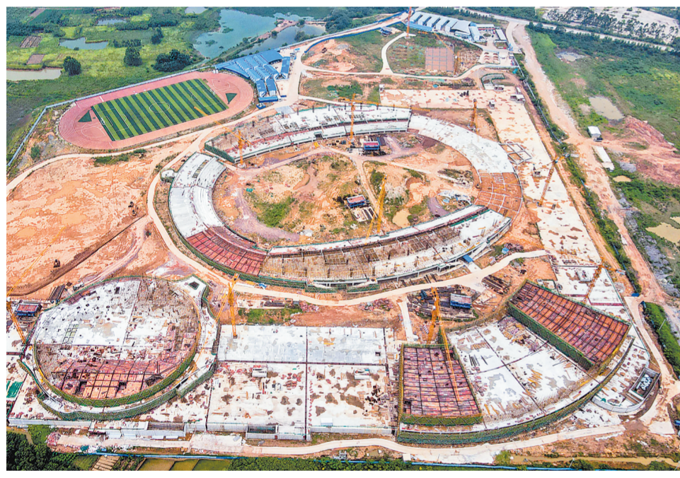
平南县文化体育中心项目总投资约12亿元,规划总用地455.96亩,主要建筑有主体育场、体育馆、综合训练馆、游泳馆等。目前体育中心地下室主体建设已全部完成,体育馆、综合训练馆计划2021年底竣工、2022年投入使用,迎接广西第十五届运动会。图为拍摄于8月10日的该项目建设现场。(记者杨小露 梁棋摄影报道)
