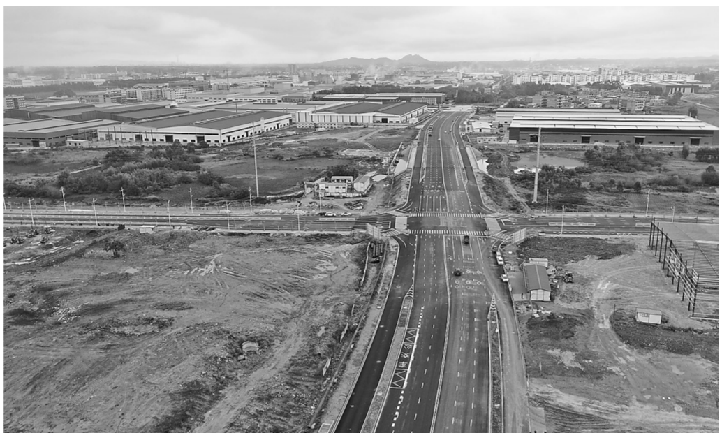
港南区新塘产业园占地6500亩，是该区正在建设的一个现代木业产业园区。目前，该园区共引进企业项目70个，其中43个已供地项目建成投产9个。全部项目建成投产后，预计总产值可达70亿元，税收约2.2亿元。图为11月8日，记者航拍的园区全景。（记者张庆杰 谭彩珍摄影报道）
