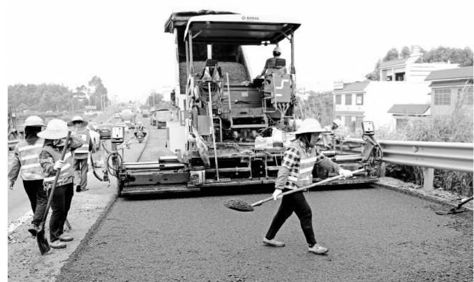
4月29日，铺路工人在贵港城区至覃塘大道（彬竹段）铺设沥青路面。（首席摄影记者张庆杰摄）
