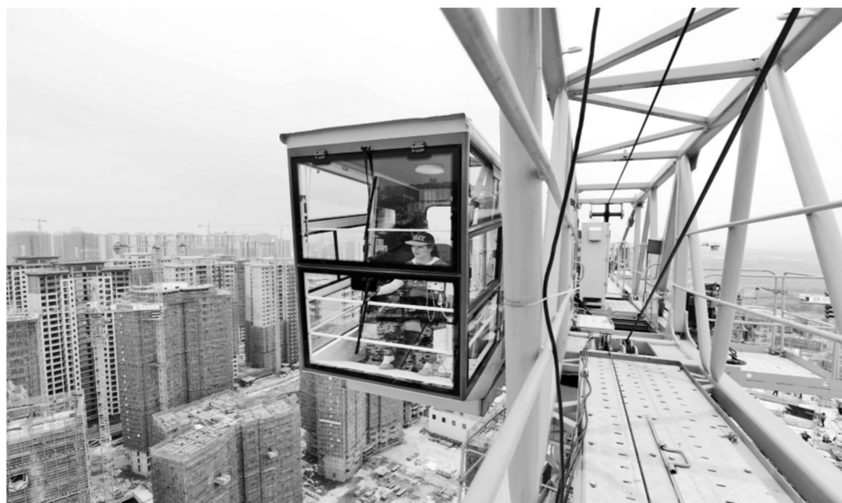
4月29日，塔吊司机在一建筑工地熟练地开展作业，用青春和汗水为贵港城市建设添砖加瓦。（首席摄影记者张庆杰摄）
