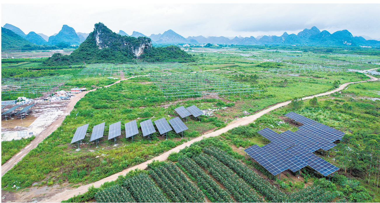
中国能建广西贵港覃塘区2000MW多能互补新能源发电项目分为北1、北2、南3区域。北1区光伏项目（一期）静态投资22.7亿元，位于樟木镇、东龙镇和山北乡附近，规划占地7000多亩，规划容量350兆瓦，于去年年底开工建设，预计今年10月底实现全容量并网发电，首年发电量可达62624万千瓦时，每年可节约标煤179442.9吨。图为6月16日拍摄的北1区光伏项目（一期）工程建设现场。（记者杨小露 梁棋摄影报道）
