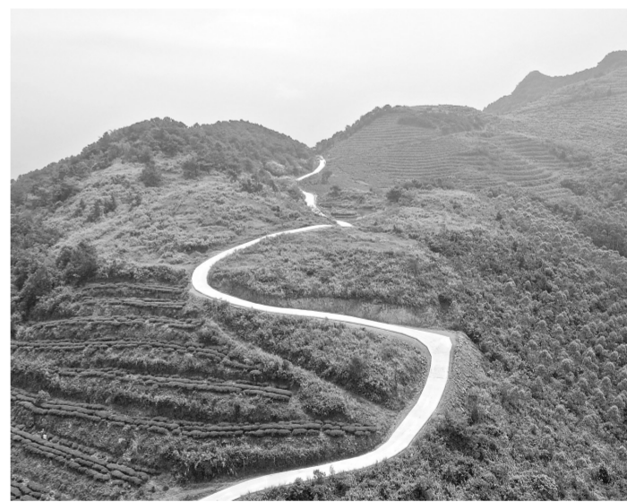
覃塘毛尖茶示范园黄练核心区一期基础设施道路全长4.89千米,共投资380万元,目前项目建设已进入尾声。该项目连通示范区的文旅服务区、生产厂区、毛尖茶采摘体验区、休息驿站等,通车后将进一步加快园区建设发展。图为近日项目现场俯瞰图。(记者蒙思婷 通讯员刘琼华 摄影报道)
